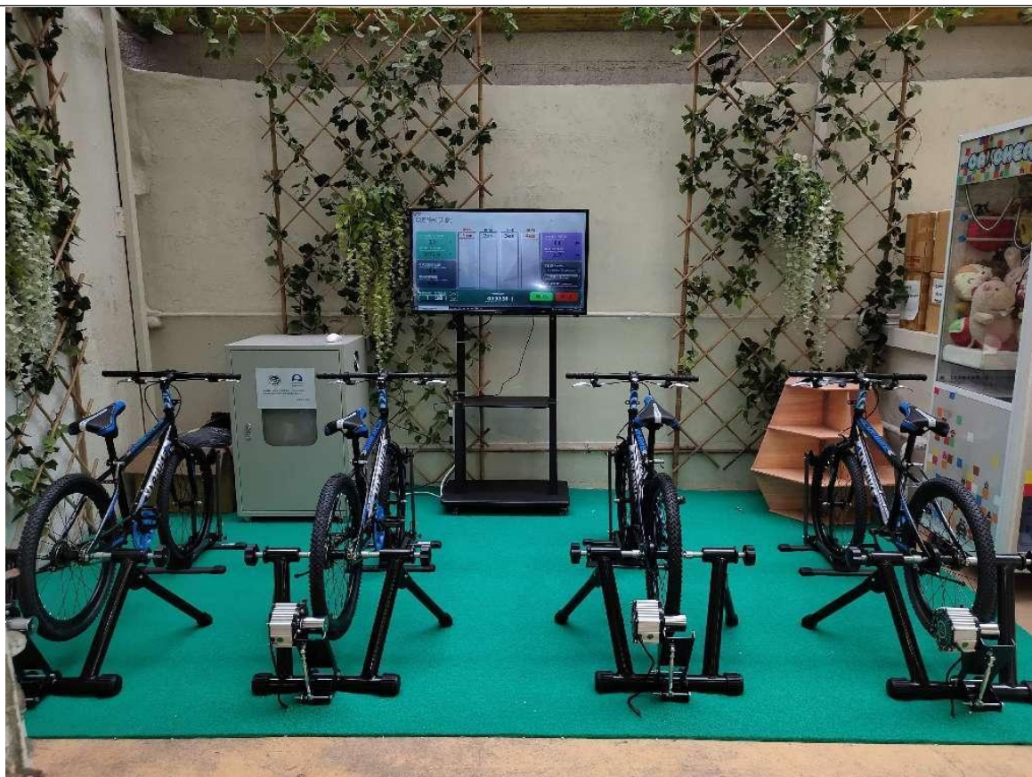
單車發電系統安裝位置相片
